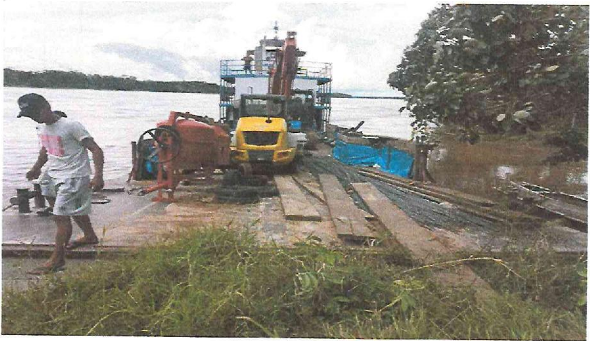
Llegada de Transporte de Materiales y Equipos a la Localidad de Mazan
