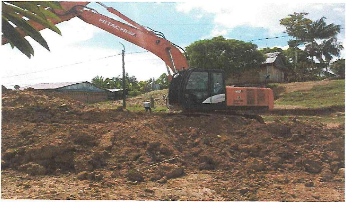
Corte de Terreno a nivel de Sub Base en la Localidad de Mazan
