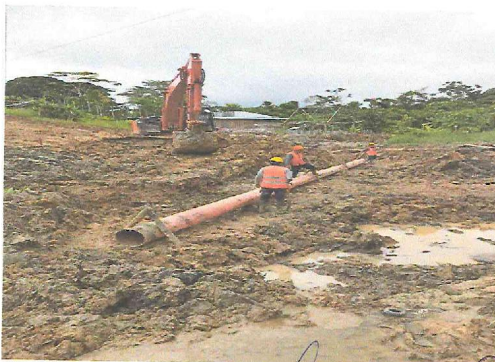
Sobre excavación en alcantarilla de cruce
