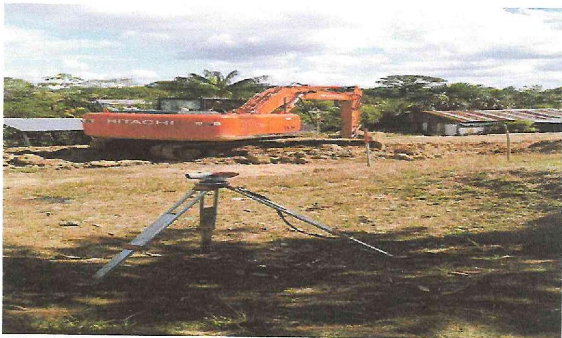
Corte de Terreno a nivel de Sub Base en la Localidad de Mazan
